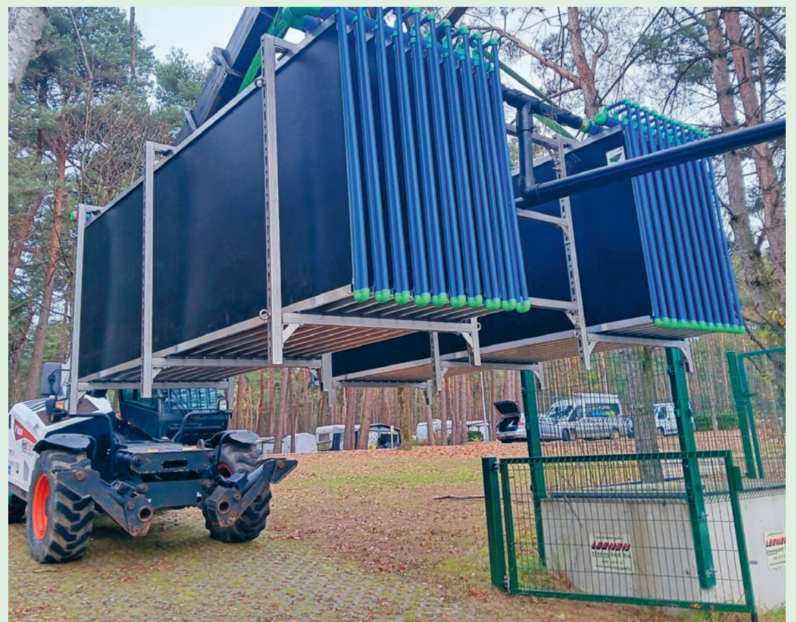
Im Dezember 2025 wurde der Wärmetauscher im Badensee von Camping De Lilse Bergen installiert.
